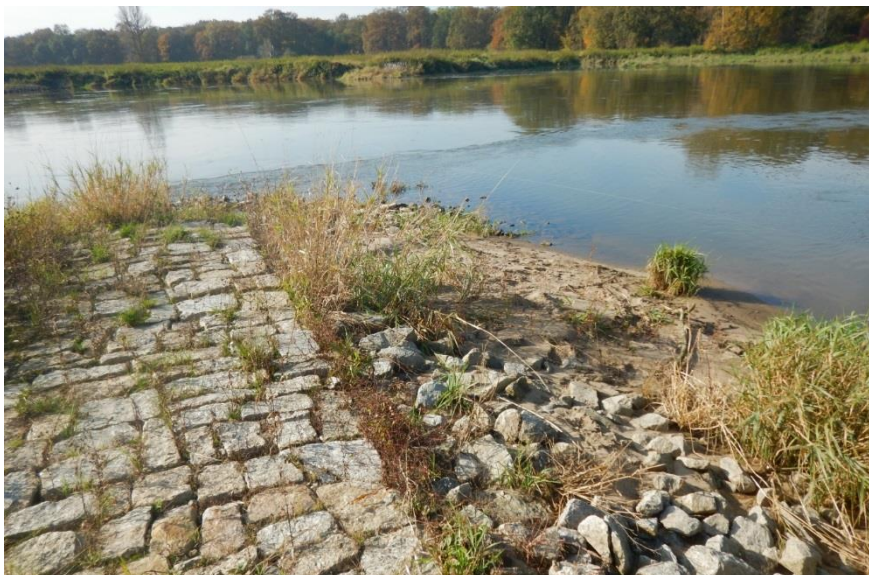
Fot. 1 Odtwarzająca się roślinność i piaszczyste odsypy na jednej z ostróg wykonanych w latach 2012-2015.
